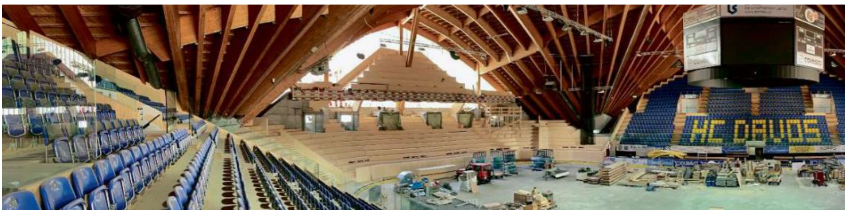
So sieht die Eishalle mit ihren sich im Bau befindlichen Ost- und Westtribünen derzeit aus.
